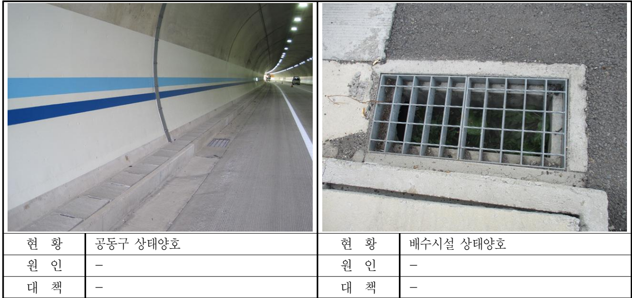
【사진 2.3.10】 공동구 및 배수시설 손상현황
